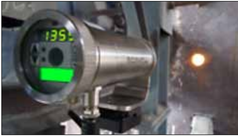
Pirómetro de resistencia montado en la plataforma del horno sin thermo jacket de refrigeración aire/agua integrada.
